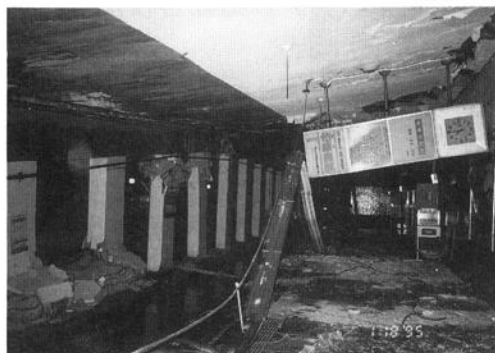
写真-V.8.1 大開駅の被災状況
