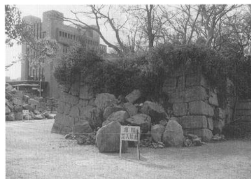
写真-V. 11. 5 石垣の被災状況
