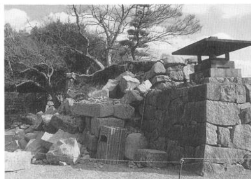
写真-V. 11. 3 石垣の被災状況
