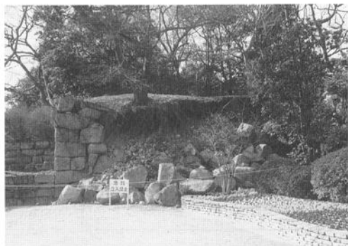
写真-V. 11. 1 石垣の被災状況
