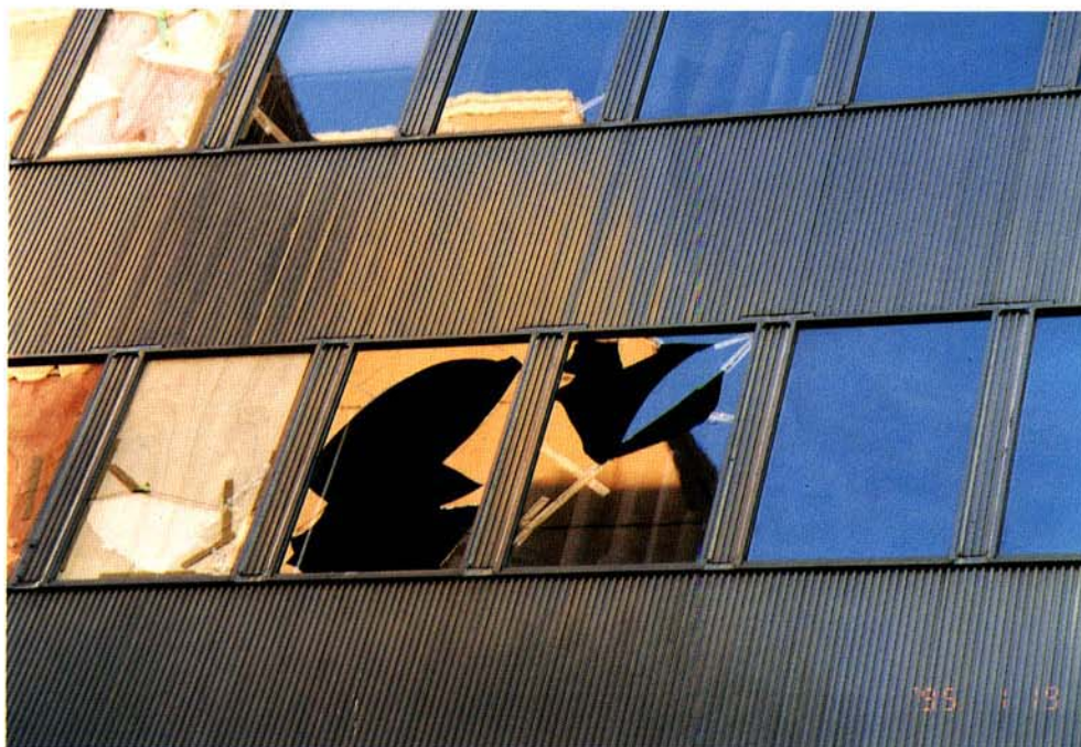
写真 2-2-1-1 構面一体形式の窓ガラス被害例
