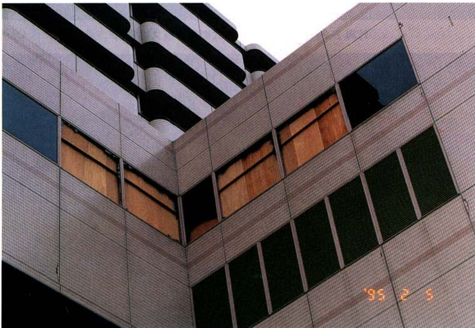
写真 2-2-1-4 Fixタイプ窓ガラスの被害例
