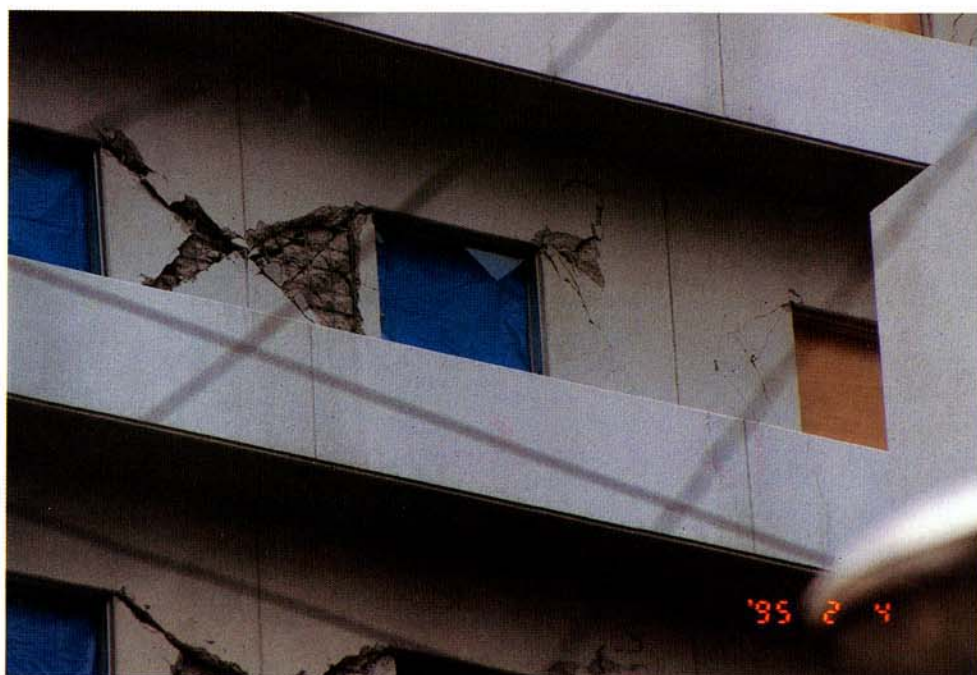
写真 2-2-1-2 壁面、独立窓共被害を受けている例
