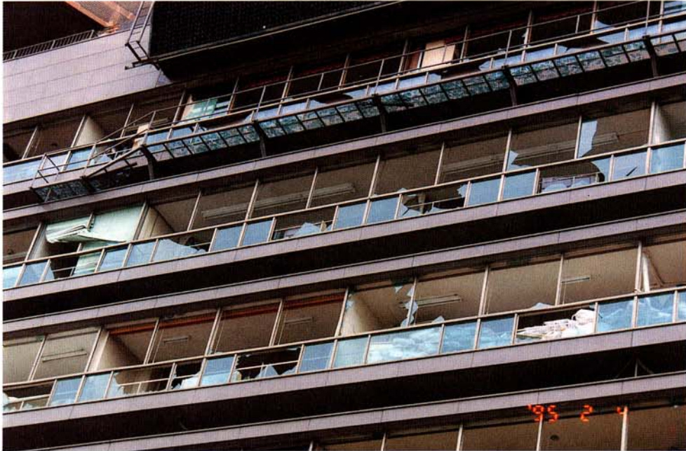
写真 2-2-1-7 パテ施工の窓ガラス被害例
