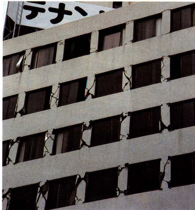
写真 2-2-1-5 壁面は被害、窓ガラスは無被害の例
