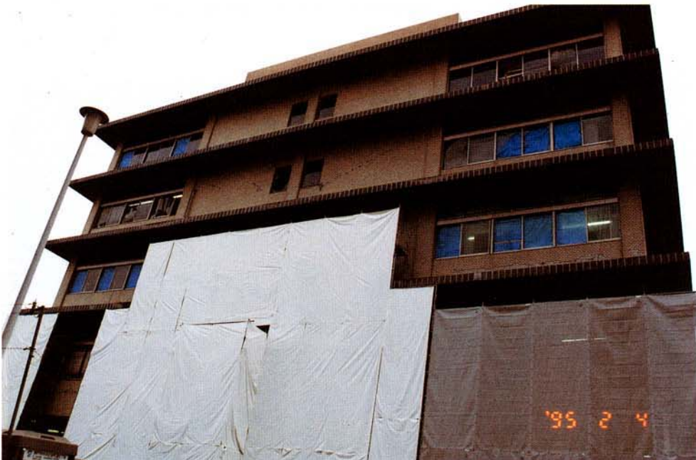
写真 2-2-1-8 パテ施工の窓ガラス被害例
