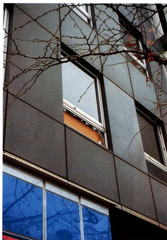
写真 2-2-2-2 独立窓の破損例
