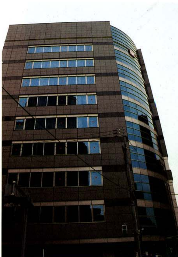
写真 2-2-2-5 無被害の横連窓
