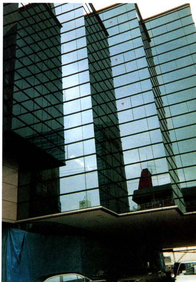
写真 2-2-2-8 1階部分の被害は大きい SSG部の被害は認められない
