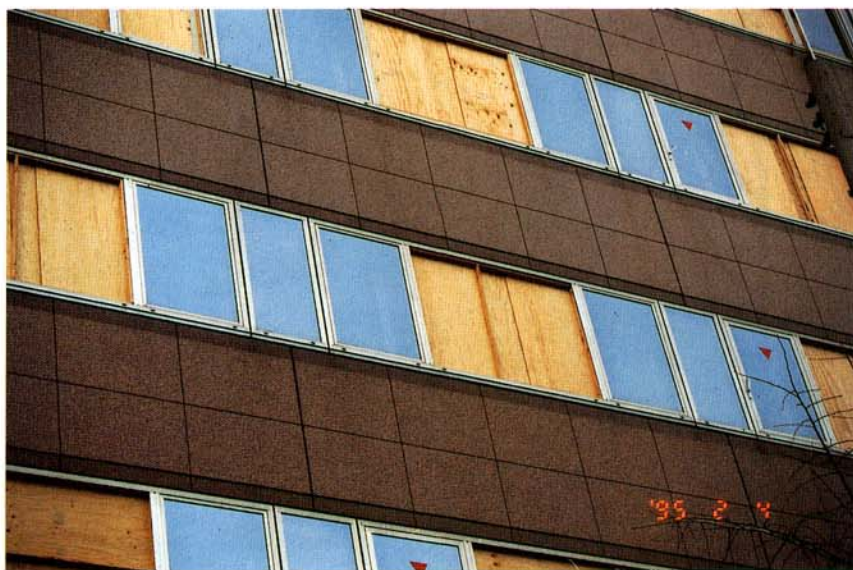
写真 2-2-2-6 横連窓の破損例
