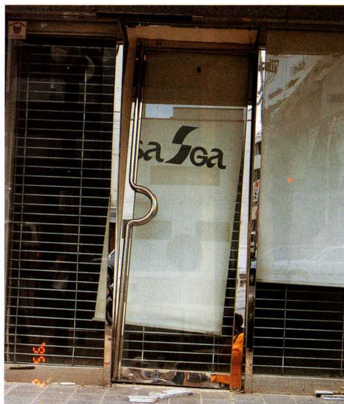
写真 2-2-3-9 枠付きガラスドアがはずれた例
