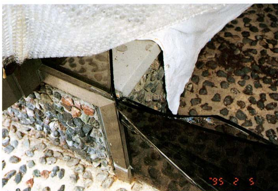
写真 2-2-3-7 角を切欠いた異形ガラスの破損例
