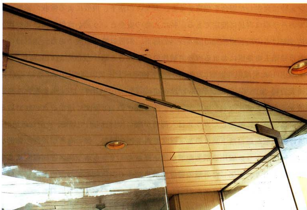
写真 2-2-3-8 強化ガラスドアのヒンジが外れて破損した例
