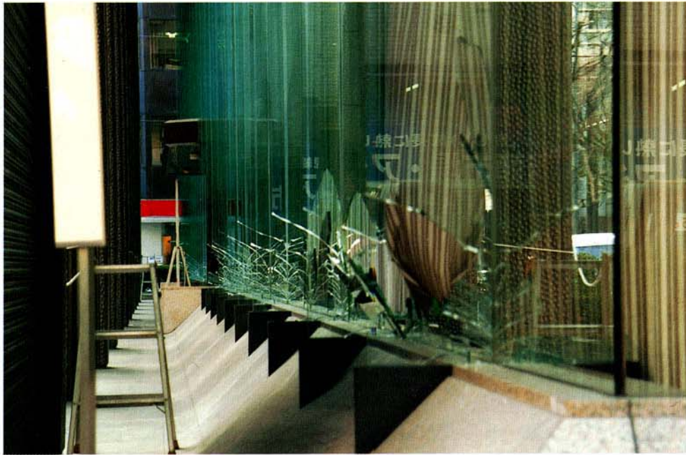
写真 2-2-3-2 大阪市内の通しリブタイプの破損例
