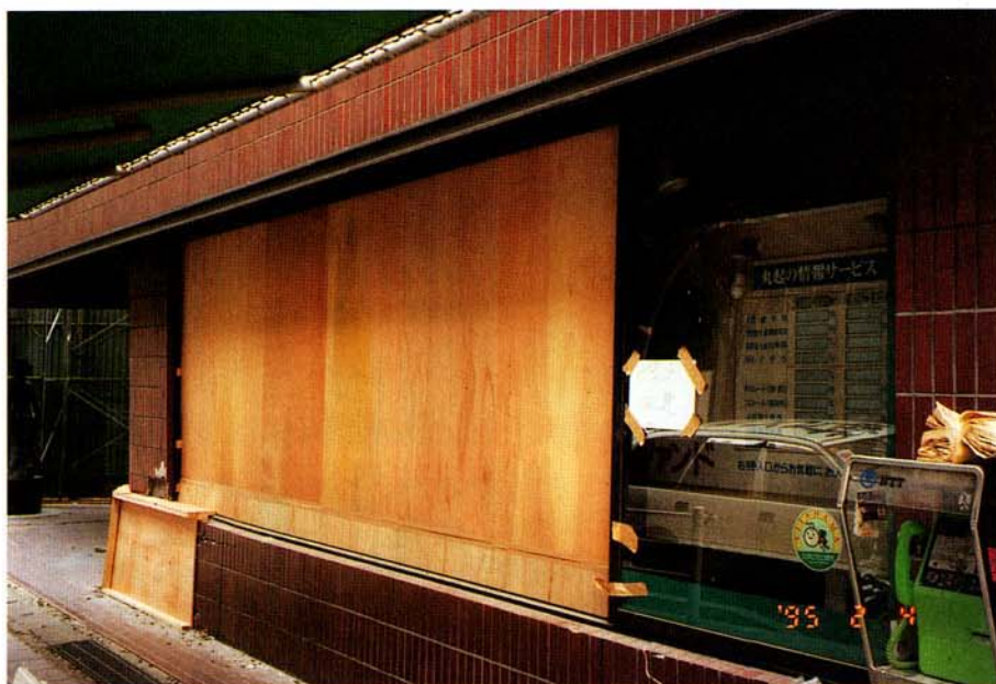
写真 2-2-3-6 1階廻りの大型窓で破損した例
