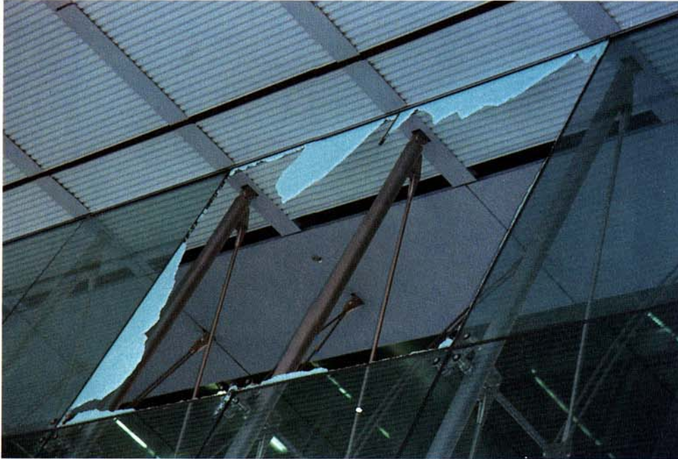
写真 2-2-3-1 点支持構法の破損例
