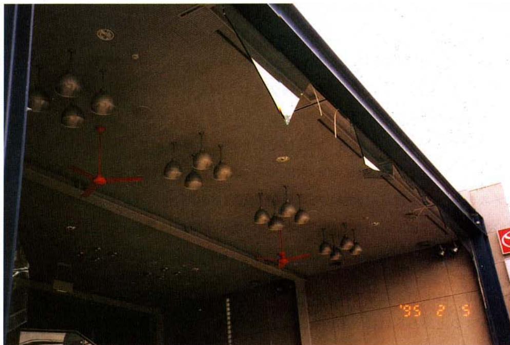
写真 2-2-3-3 芦屋市内の全面破損の例
