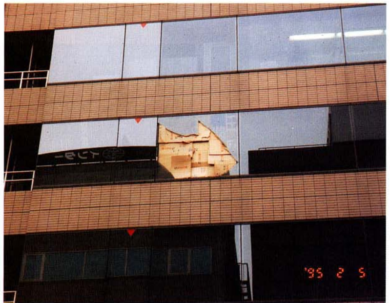
写真2-3-2 内部からの物体衝突による破損例
