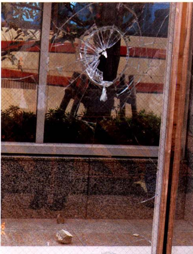
写真2-3-1 外部から飛来した物体による破損例
