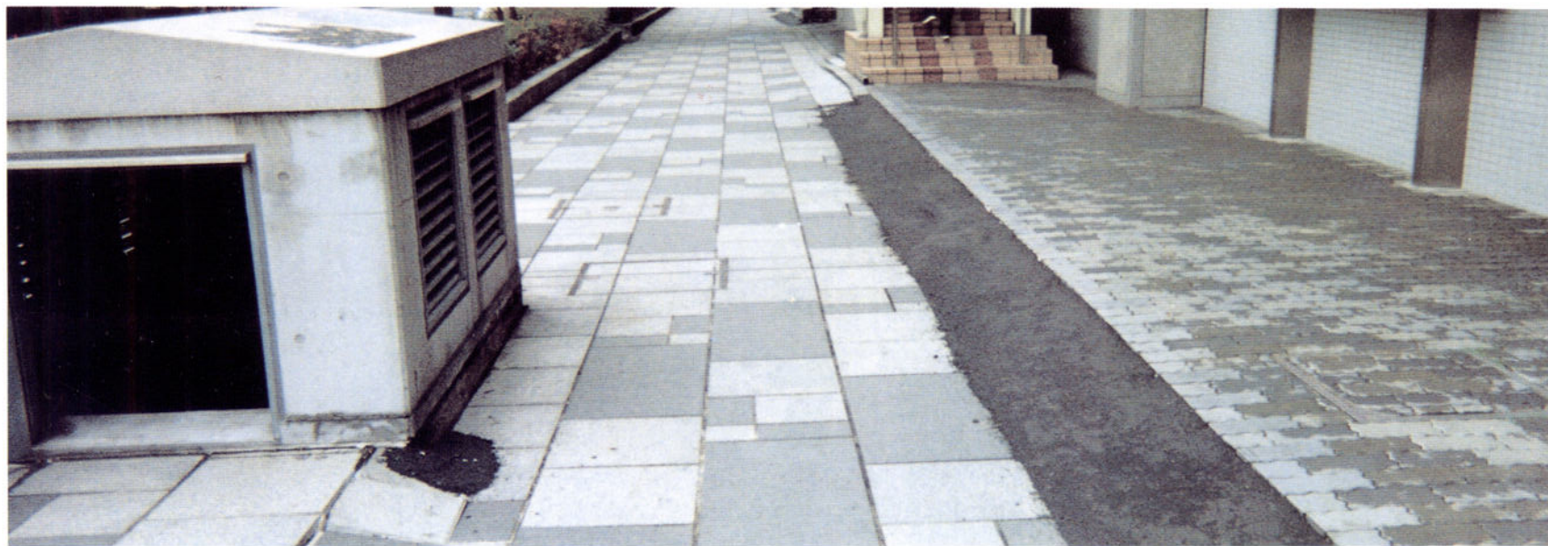
写真-6.10 神戸市海岸通り七丁目付近 共同溝出入口部構造物の損傷なし
