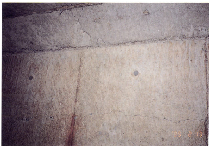
写真-6.11 神戸市海岸通り 七丁目付近
