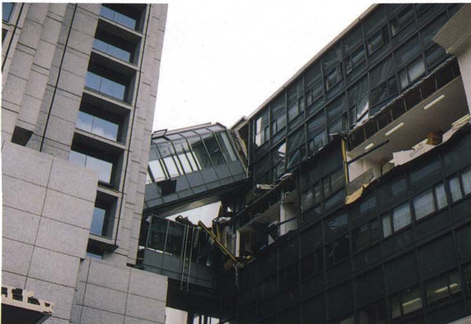
崩壊した神戸市役所庁舎 (左・1号館、右2号館) (1月18日、中央区加納町)
